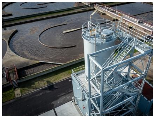
PACAS-installatie op rioolwaterzuivering Dinther
